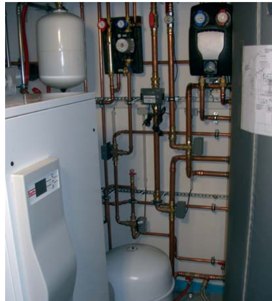
Fotos oben: Roth Solargeo® E x Energiesystem im Einfamilienhaus, Burgsinn, Deutschland
